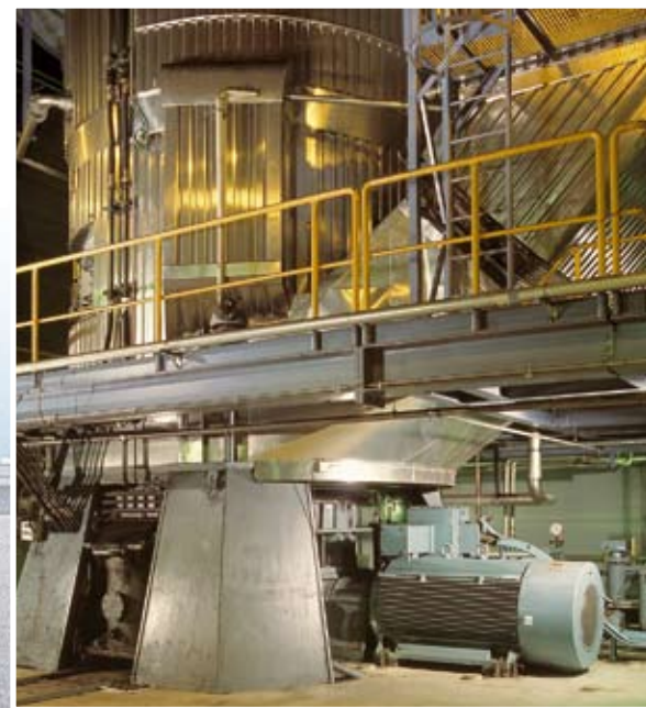
Электростанция Meri-Pori, двигатель угольной мельницы
